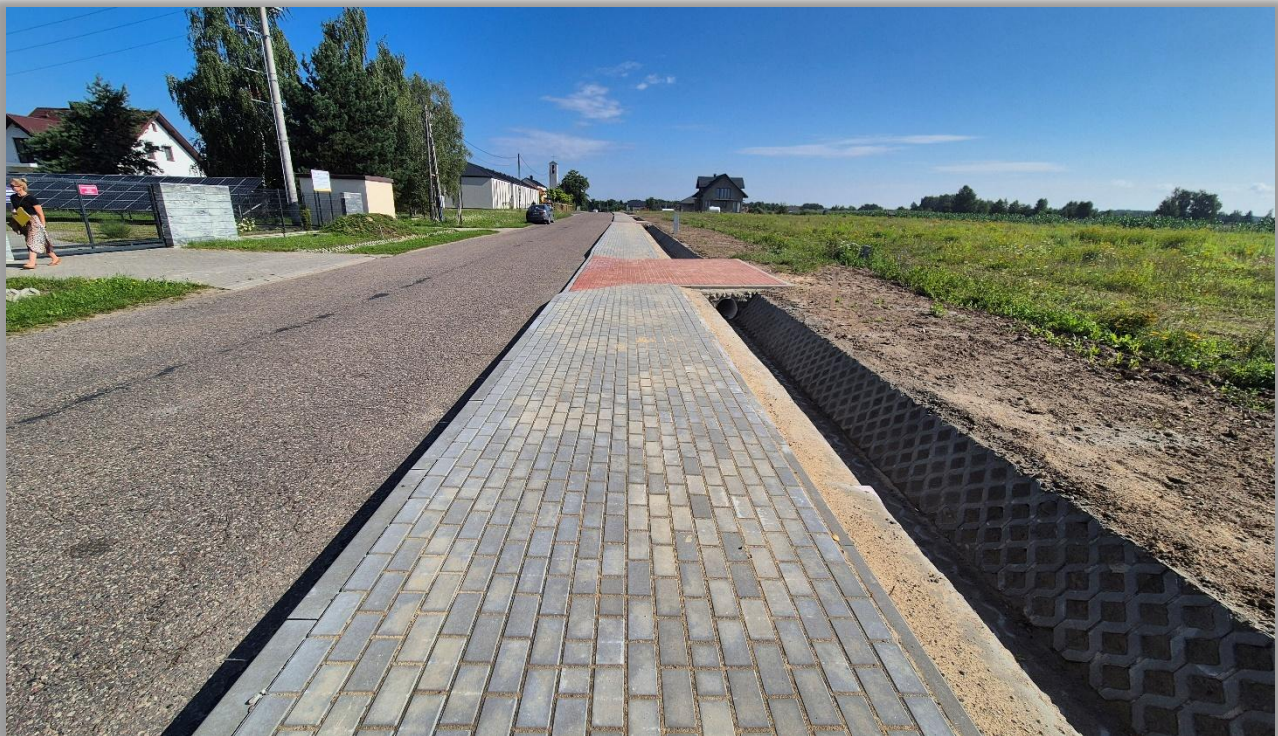
Przebudowa drogi powiatowej nr 2224W Stara Niedziałka – Mistów – Libertów polegająca na budowie chodnika od km 2+176 do km 2+444 (268 mb), m. Mistów
