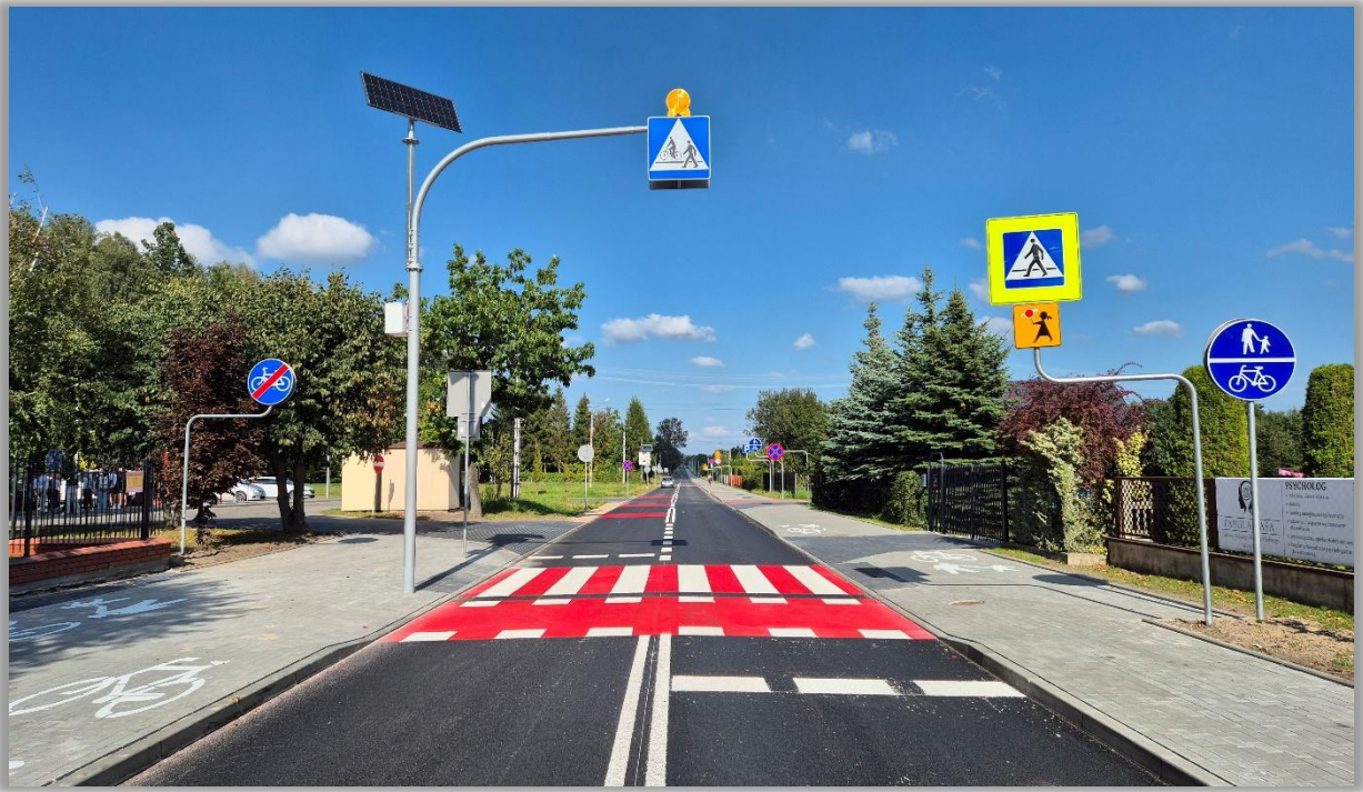
Przebudowa drogi powiatowej nr 2230W Mińsk Mazowiecki – Cegłów – Mrozy od km 11+517 do km 11+977 (460 mb), ul. Poprzeczna, m. Cegłów
