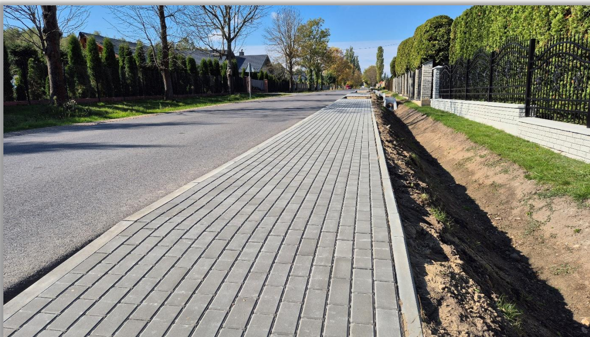
Przebudowa drogi powiatowej nr 2738W Kołbiel – Siennica polegająca na budowie chodnika od km 7+234 do km 8+199 (965 mb), m. Gągolina
